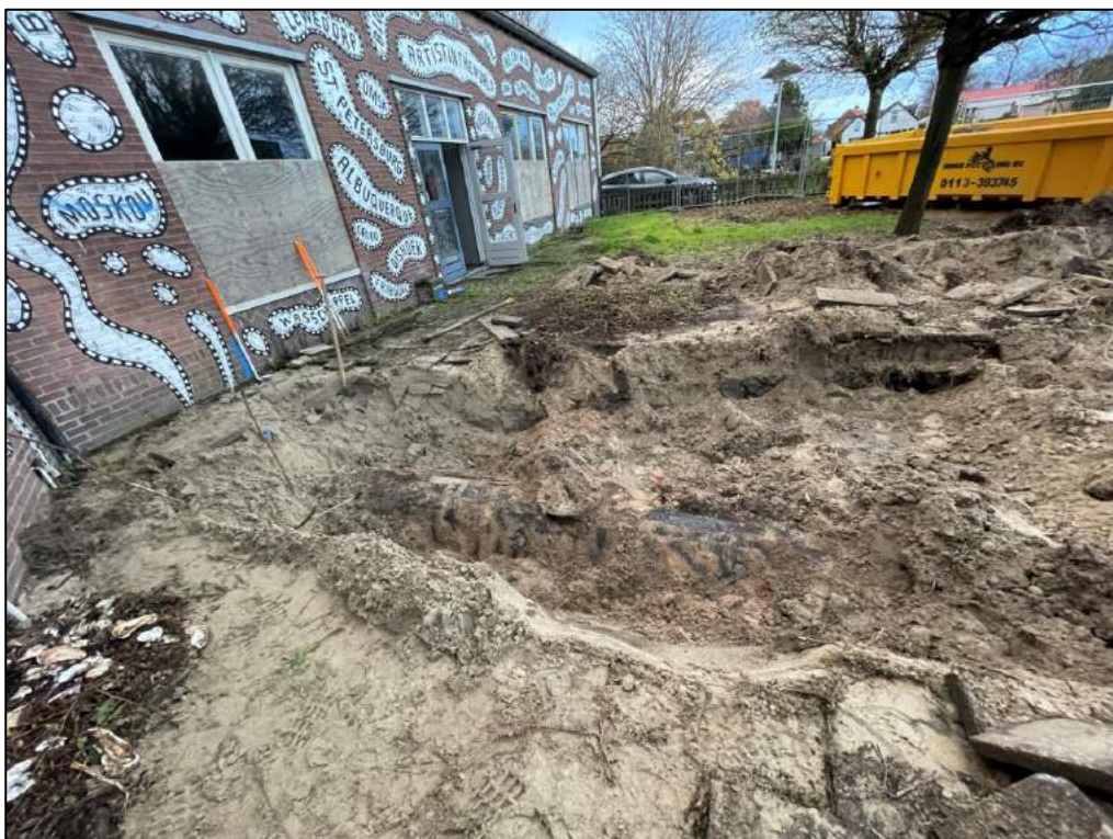
Foto 2: Ondergrondse HBO-tank, zie fotorichtingen in tekening in bijlage 2
