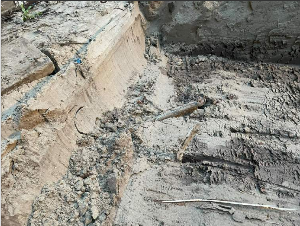
Foto 7: Leidingwerk richting voormalig ontluchtingspunt
