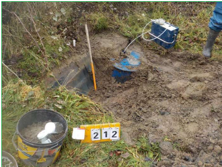
Foto 7. Ingegraven vat ter hoogte van PG212.
