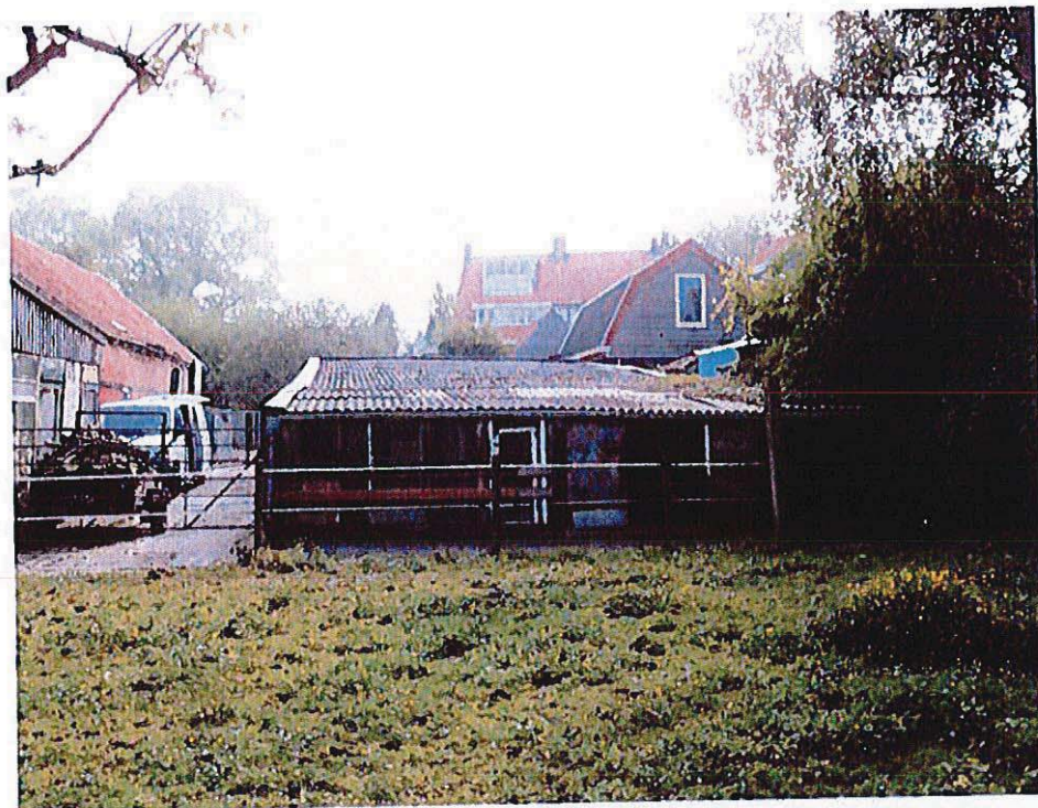
Foto 7: foto hangar gezien vanuit het westen kijkend naar hangar, asbestgolfplaten duidelijk zichtbaar.
