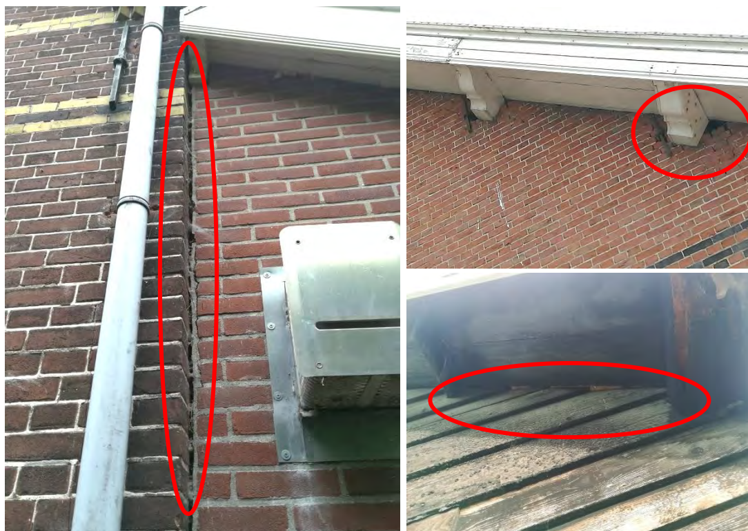
Afbeelding 7. Voorbeelden van aangetroffen holtes die toegang kunnen bieden tot een potentiële verblijfplaats van vleermuizen (foto's: Laneco, 2020).
