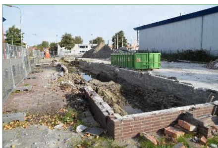
Locatie 1: Gesloopt gebouw.
