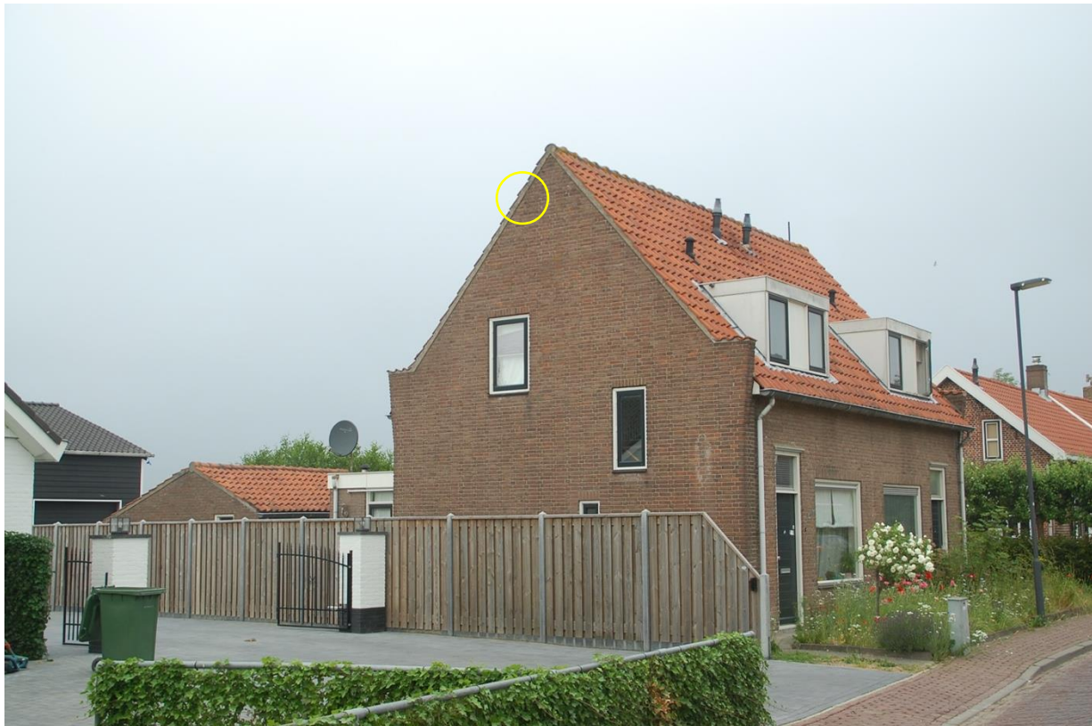
Figuur 3: Onder een van de (losse) kantpannen is een vleermuisverblijf.
