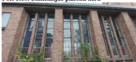
Foto 3.12: Buitenzijde ramen zijgevel kerk
