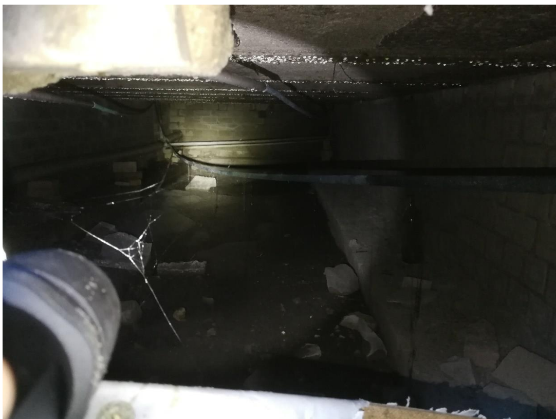
Figuur 4 Kruipruimte onder leegstaand woonhuis.
