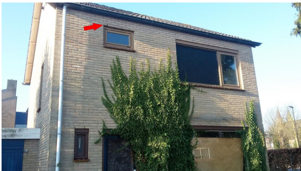
Figuur 4.5.4. Loszittend voegwerk in de voorgevel van de leegstaande woning met mogelijk een vleermuisverblijf.
