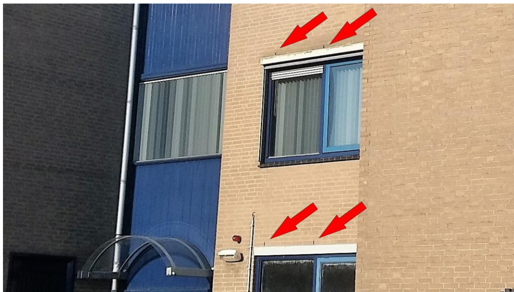
Figuur 4.5.6. Open stootvoegen (aangegeven met rode pijlen) boven de ramen van het politiegebouw, waardoor vleermuizen de spouw kunnen bereiken.
