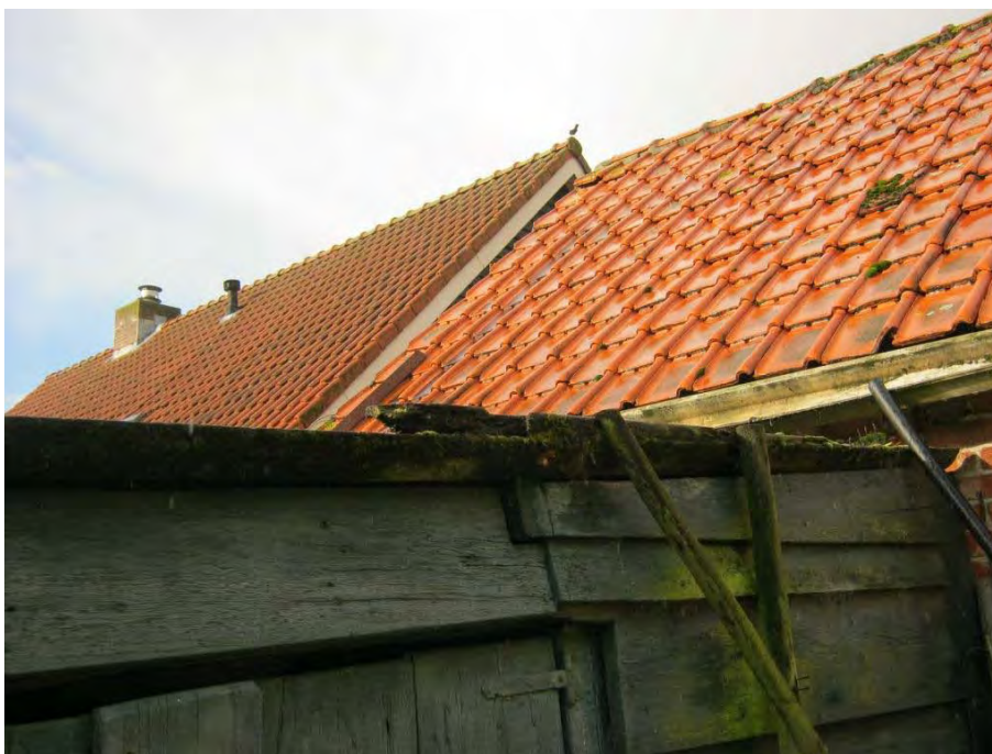
IMG_1137, Dak van houten schuurtje met verouderd dak van asbestverdacht plaatmateriaal.
