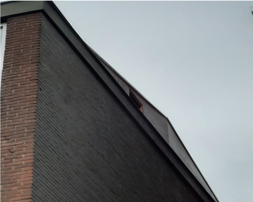
Afbeelding 7: Door een opening in de trespa beplating is de ruimte onder het dakvlak toegankelijke voor huismus en gierzwaluw. Foto: M.M. Bouwmeester | Ecoresult B.V.
