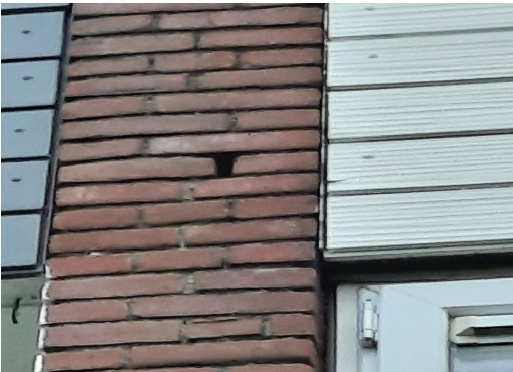
Detail van een open stootvoeg in een penant. Deze biedt toegang tot eventueel aanwezige verblijfplaatsen van vleermuizen. Foto: M.M. Bouwmeester | Ecoresult B.V.
