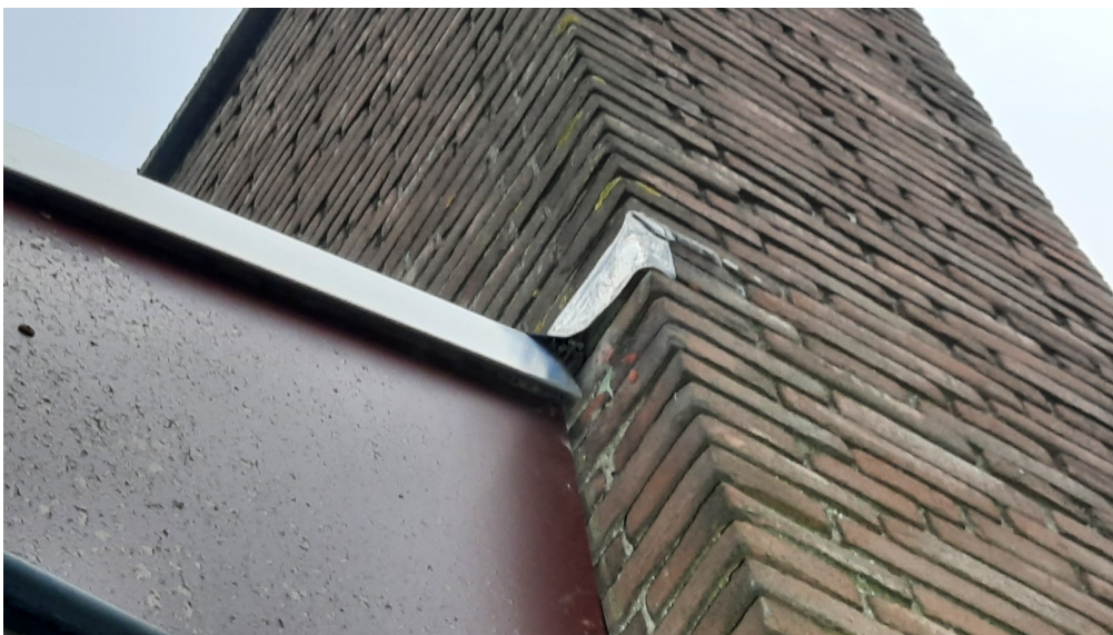
Wijkende loodflap binnen het plangebied welke vleermuizen toegang
