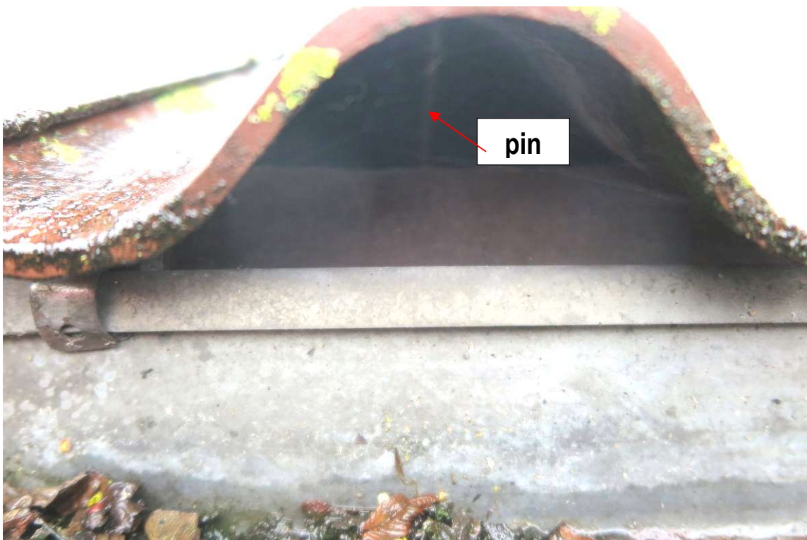
Figuur 5. Ongeschikt dak van de bedrijfsloods aan de Dorpsstraat 78-80 te Heerjansdam voor huismussen doordat het dak vast zit met pinnen. Het ontbreekt daarnaast aan sporen van mussen (mede vastgesteld met endoscoop).
