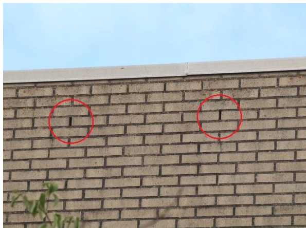
Figuur 6. De open stootvoegen (rode cirkels) in de westelijke gevel van de aanbouw.
