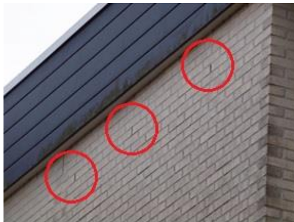
Figuur 7. Aan de noordzijde van het gebouw zitten open stootvoegen en houten boeiboord.
