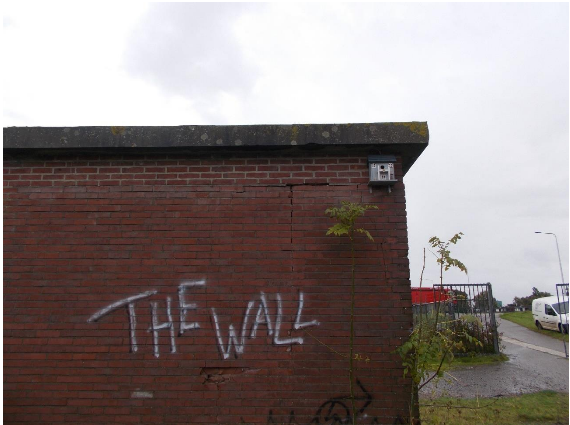
Figuur 4: Diepe scheuren in de muur bevatten toegang tot de spouw voor vleermuizen.
