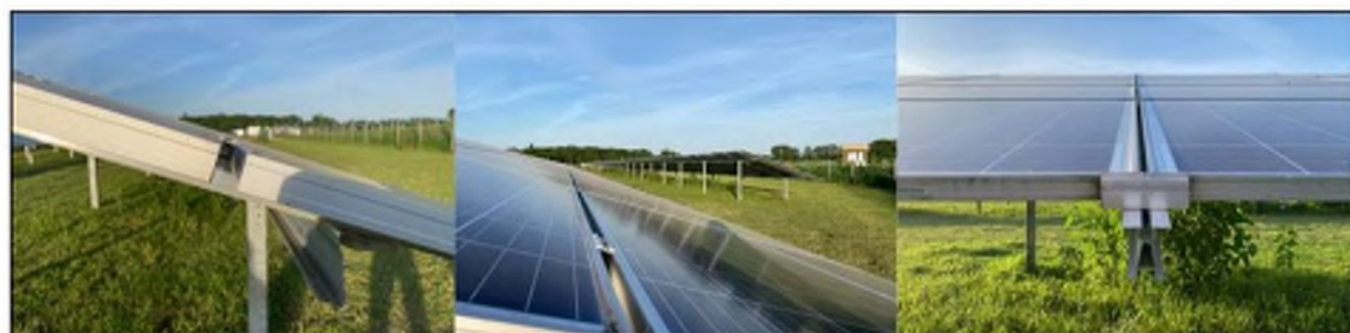
Afbeelding 25. Opstelling pv-panelen, waardoor voldoende ruimte is voor infiltratie regenwater (bron: [redacted])
