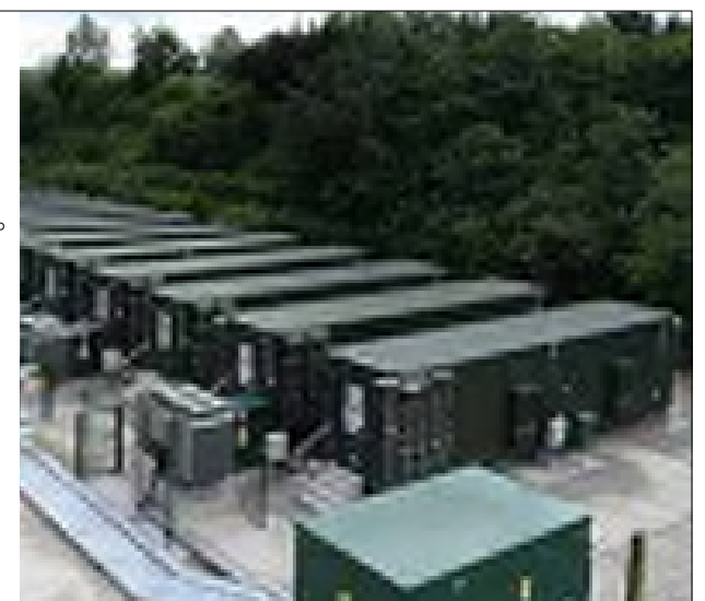
afb. 40: opstelling batterijen (www)
