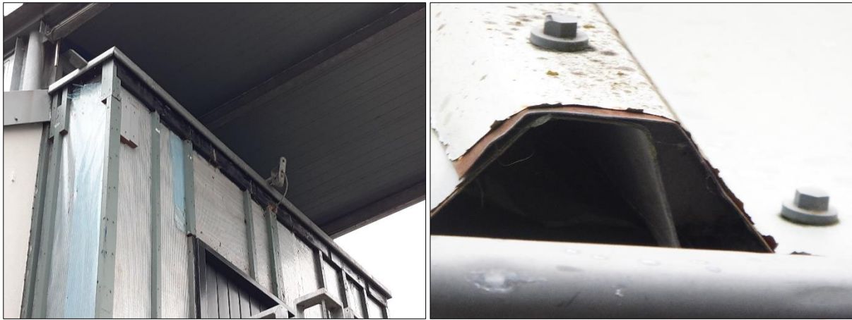
Figuur 4-1. Openingen in het hoofdgebouw waar huismus (en vleermuizen) kunnen invliegen.
