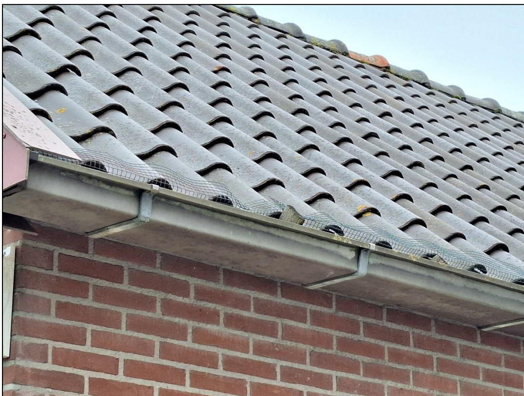
Figuur 4. Aanwezig gaas op dakpannen bij naastgelegen schuur.
