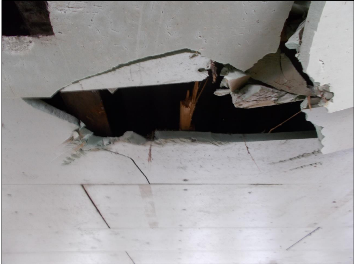
Figuur 9: Gaten in dakbeschot aan binnenzijde schuur.
