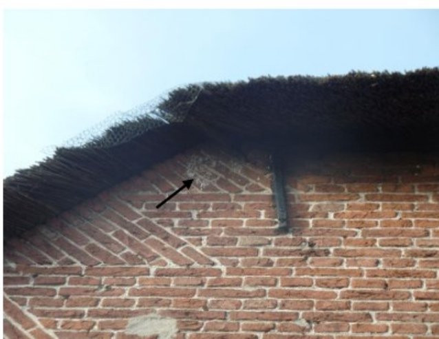
Figuur 12: Sporen van vleermuizen op de gevel van de boerderij
