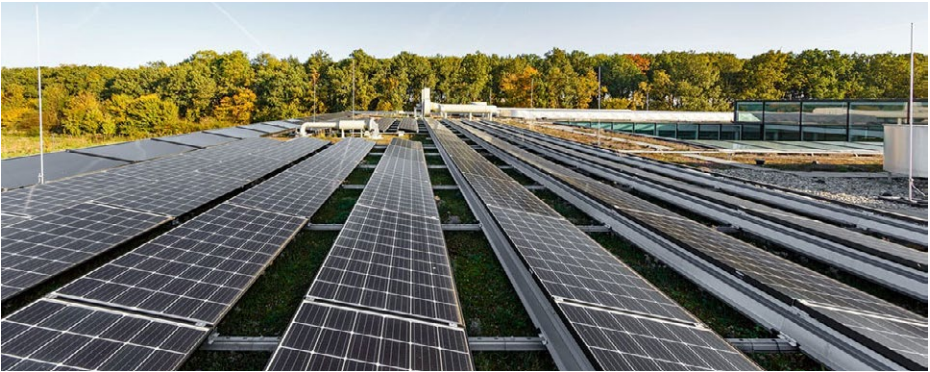
Groen dak gecombineerd met zonnepanelen
