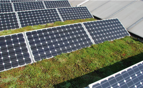
Groen dak gecombineerd met zonnepanelen
