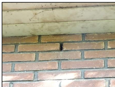
Figuur 7. Een van de open stootvoegen in de woning.
