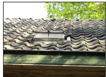
Figuur 8. Los zittende dak- en nokpannen van de woning.
