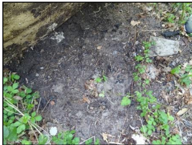
Figuur 13. Muizennesten onder de houten plaat.
