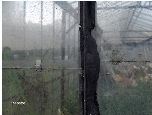
Asbesthoudende beglazingskit (zwart).
