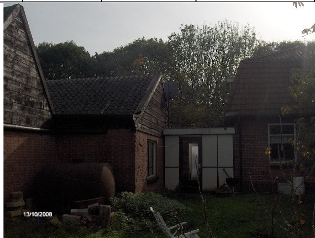
Schuur links voorzien van asbesthoudende golfplaat.
