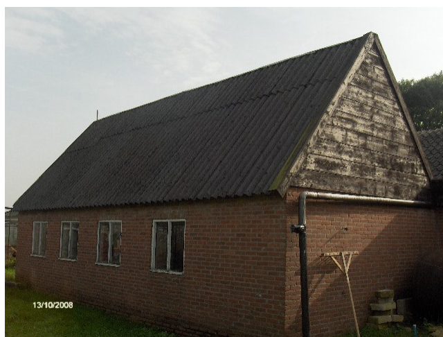
Schuur links achter de woning; asbesthoudende golfplaat.
