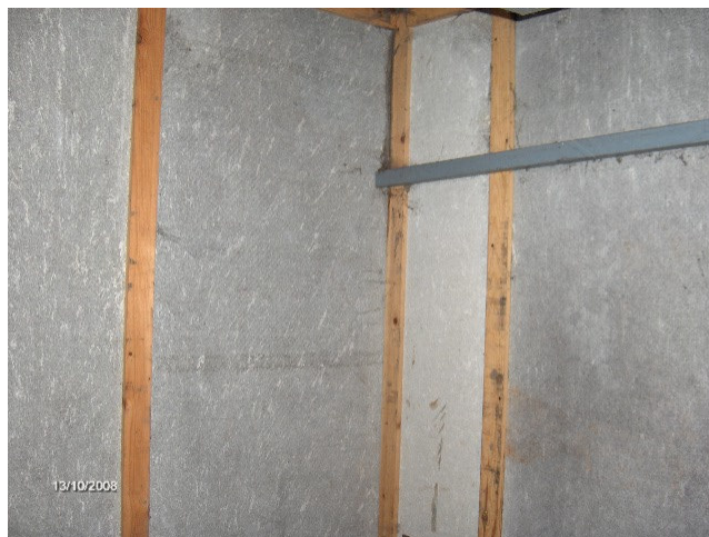
Interieur koelcel; asbesthoudende plaat.
