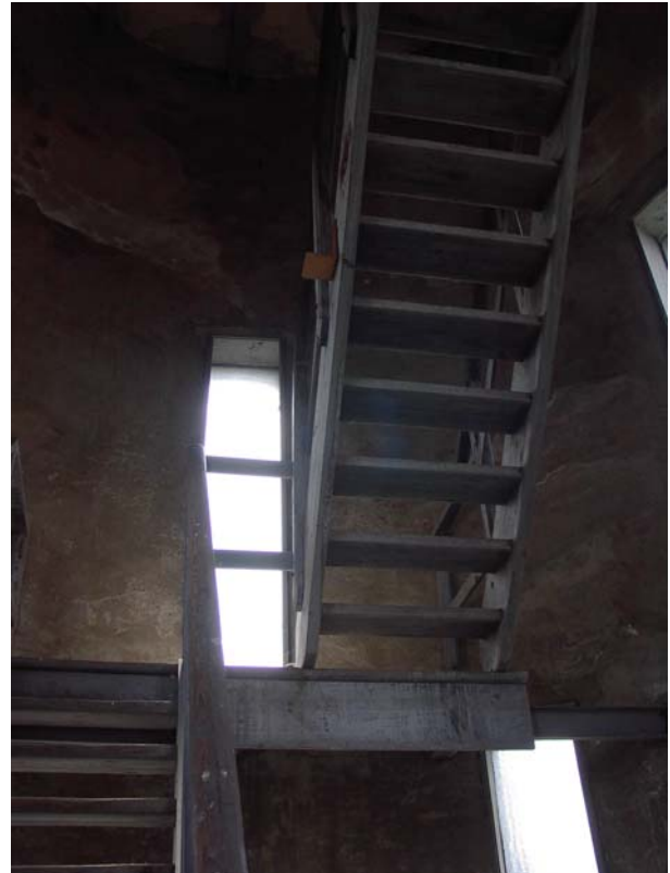
Gevelopening in de wand van de 2 de verdieping. Veel vochtplekken boven de hoogste rij gevelopeningen.
