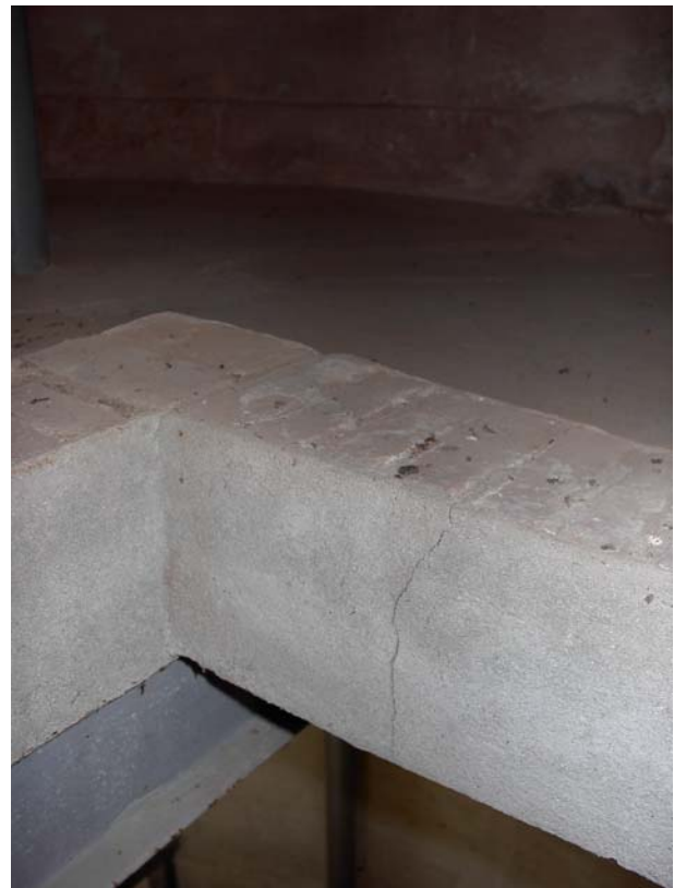
Bovenzijde 3 de verdiepingsvloer t.p.v. trapsparring. Versterking in vloer.
