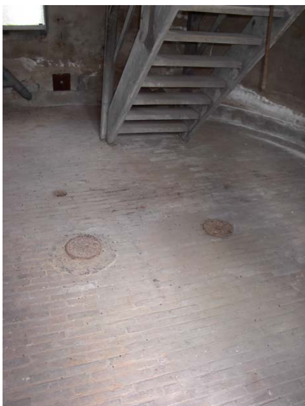
Afgezaagde oude leidingen (links) en een kijk- of peilgat (rechts) in de begane grondvloer.
