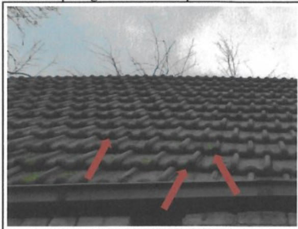
Foto 12: openingen tussen de dakpannen
