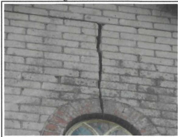
Foto 10: scheur in gevel schuur
