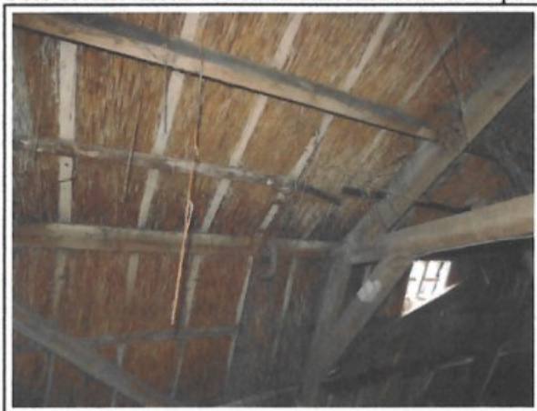
Foto 15: riet tussen de houten dakconstructie en de pannen
