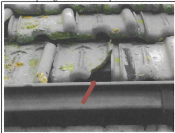
Foto 13: openingen tussen de dakpannen
