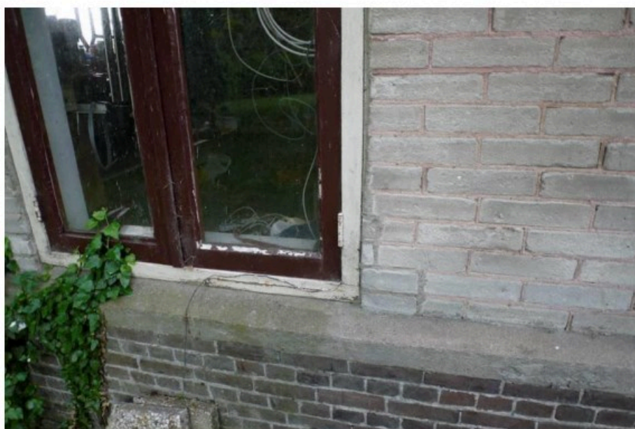
Afbeelding 13: metselwerk aan de rechter dagkant van het kozijn laat zien dat de opening niet uit de bouwtijd is. Stenen zijn met wisselend succes gekapt. Reparatie met moderne kalkzandsteen is hier noodzakelijk geweest.
