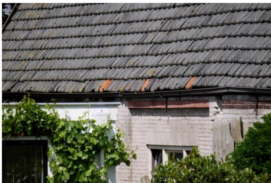
Afbeelding 32: Moderne dakgoot en plaatselijk vervangen kruispannen in het westelijk dakvlak.
