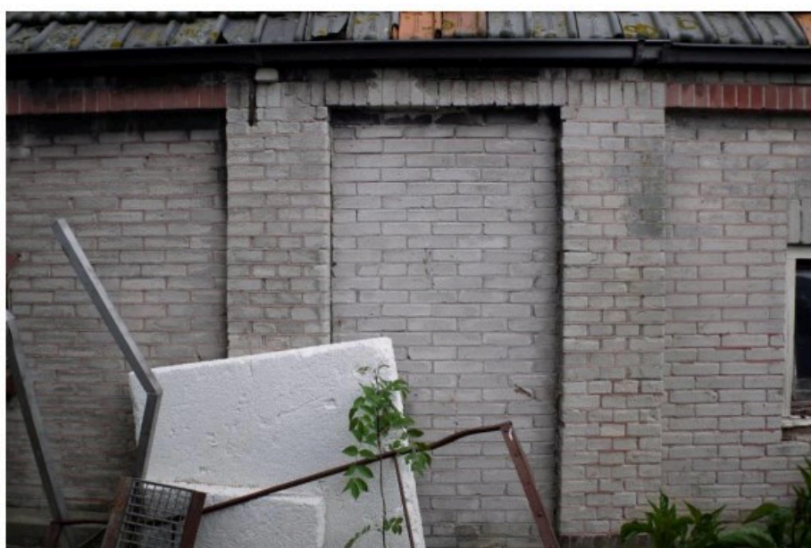
Afbeelding 23: Tweede spaarveld, dichtgezette deuropening. Hier zijn moderne kalkzandstenen toegepast.
