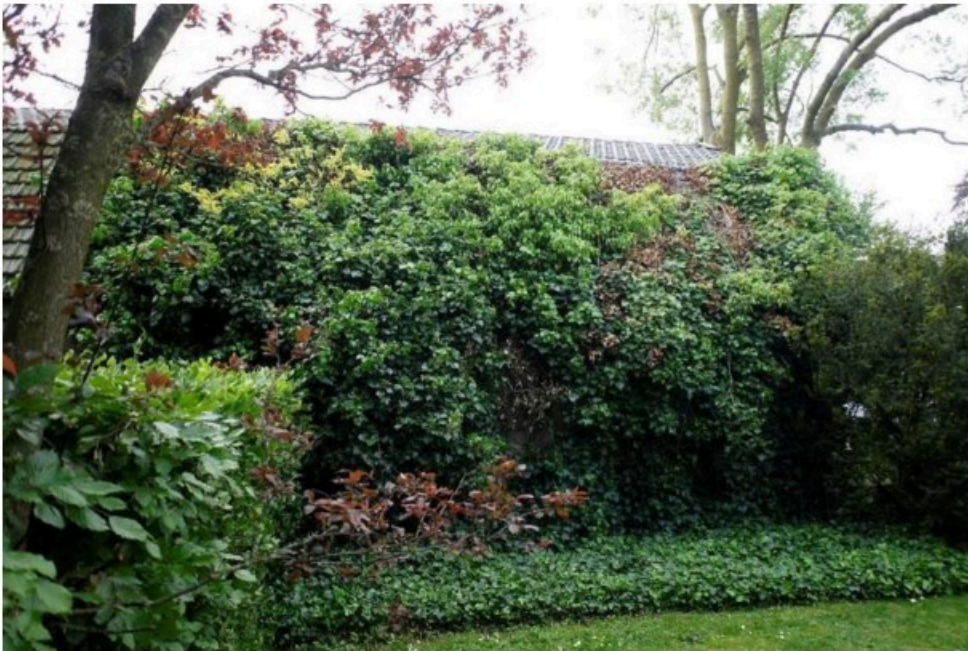
Afbeelding 11, dichtbegroeid noordelijk deel van de oostgevel, het gevelwerk kon niet worden geïnspecteerd op dit gedeelte.
