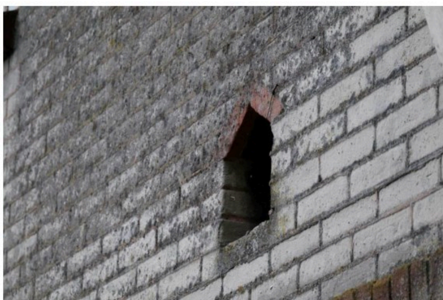
Afbeelding 19: sparing in gevel op het niveau van de eerste verdiepingvloer. Voegwerk is vervuild maar de oranje kleur is nog plaatselijk zichtbaar.
