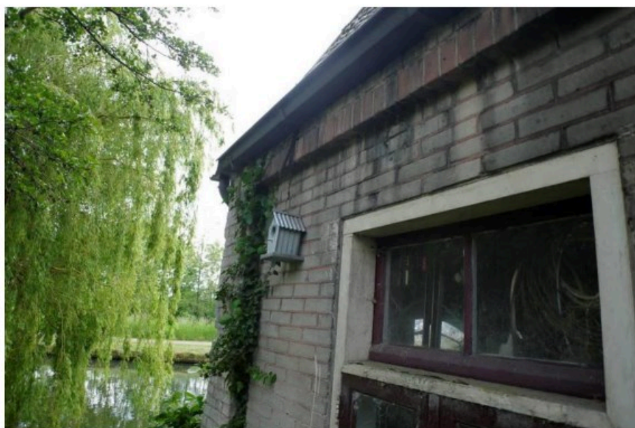
Afbeelding 16: gootanker dat de voormalige goot ondersteunde. Tegenwoordig is een nieuwe kunststof goot geplaatst.
