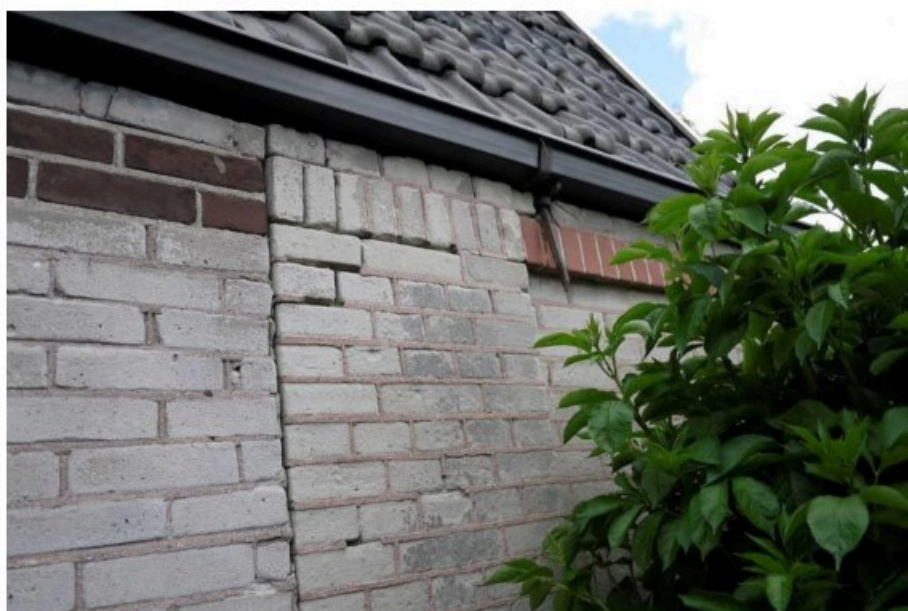
Afbeelding 26: Zuidelijk deel van de oostgevel. Gootanker zichtbaar op de rollaag van oranje kalkzandsteen. Bemerkt het verschil in kleur en lagenmaat tussen het nieuwe en oude metselwerk.
