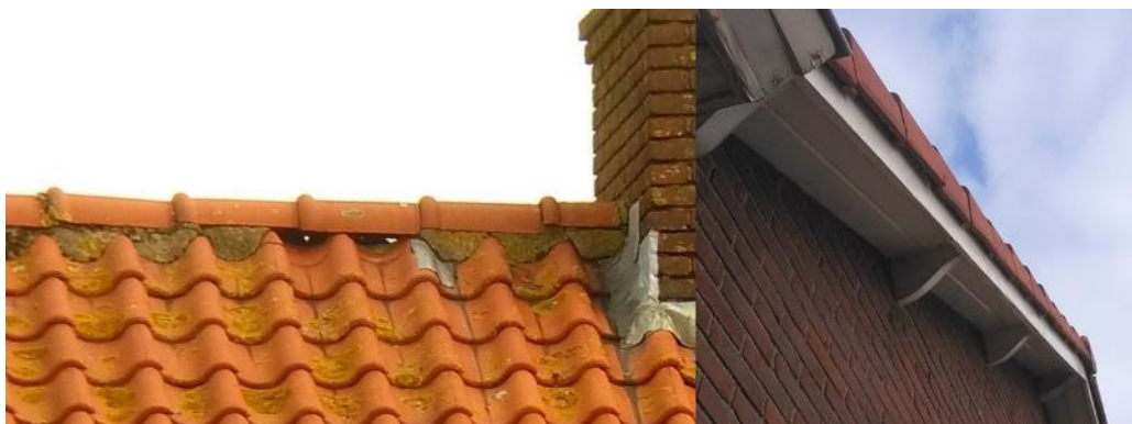
Figuur 3 Onder de nok van de bedrijfswoning mist een deel van de specie waardoor openingen zijn ontstaan die mogelijk tot de dakruimte leiden (links). Onder de kantpannen zijn ruimtes aanwezig (rechts) die mogelijk kunnen dienen als verblijfplaats van vleermuizen.
