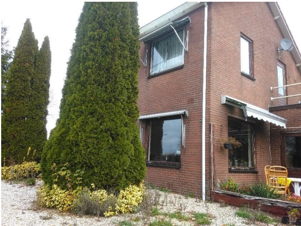
Figuur 6 In de bedrijfswoning is een spouwmuur en enkele open stootvoegen aanwezig. De meeste open stootvoegen zijn zeer laag gelegen, op een hoogte van enkele centimeters (onder raam op foto). Enkele stootvoegen zijn op een hoogte van ongeveer 3 meter gelegen, achter een hoge conifeer.
