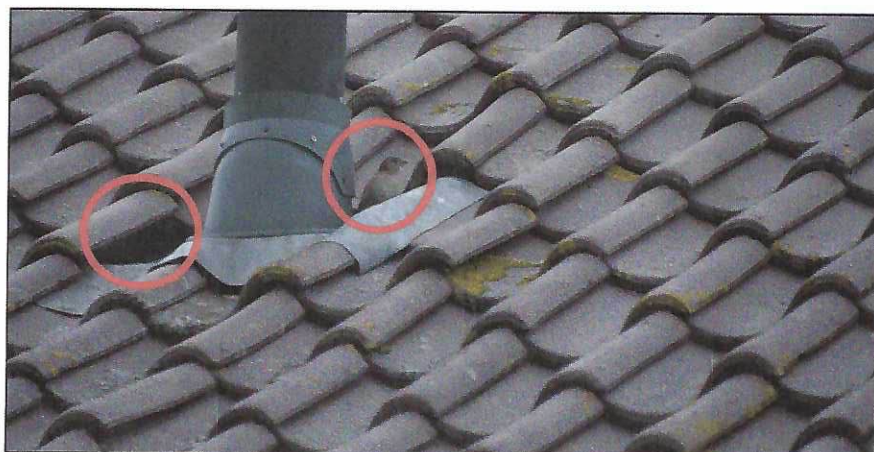
Figuur: er zijn huismussen op het dak waargenomen nabij openingen onder de dakpannen (rood omcirkeld).
