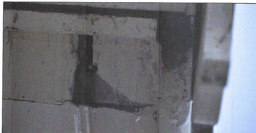
Figuur: op verscheidene plekken zijn kleine openingen waargenomen. Deze verschaffen mogelijk toegang tot verblijfplaatsen van vleermuizen.
