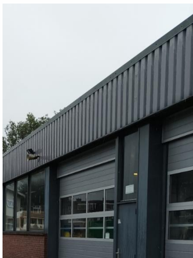
Figuur 4.4.3. Het dak van het bedrijfspand heeft geen kieren of openingen bij de windveer.
