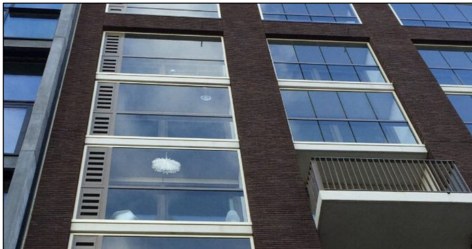
Figuur 6.1: Verglaasde balkons met ongedempte ventilatieopeningen (boven) en gedempte ventilatievoorzieningen (onder)
