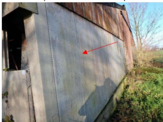
Foto 24 | Foto voor bron Gevelpanelen
