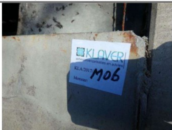
Foto 22 | Foto voor bron Gevelpanelen
