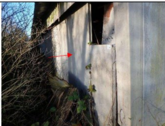
Foto 23 | Foto voor bron Gevelpanelen
