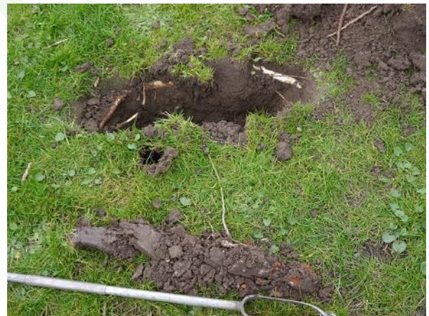
Afbeelding 15: oppervlakkige beworteling en roestvorming op 50 cm diepte.
