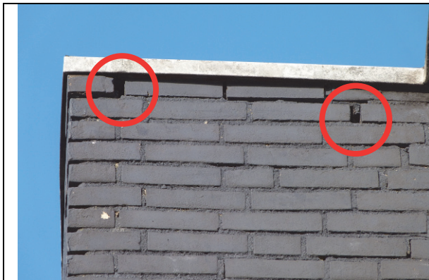
Figuur 9: Open stootvoegen (rood omcirkeld) in de zuidelijke buitenmuur van de supermarkt.
