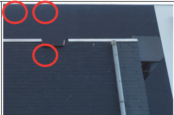
Figuur 10: Open stootvoegen (rood omcirkeld) in de oostelijke buitenmuur van de supermarkt.
