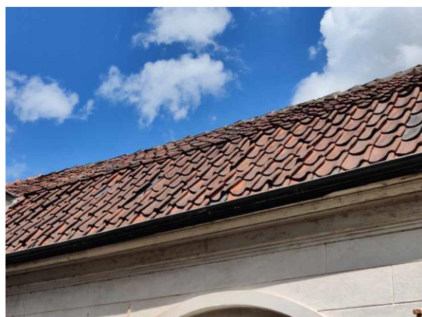
Figuur 12 Los en scheef liggende dakpannen met daaronder direct de open ruimte van de zolder
