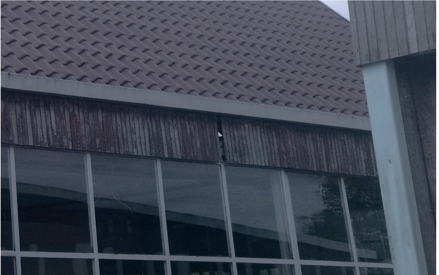
Foto 3: de opening in de rui houten planken leidt direct tot de op en zolderruimte.
