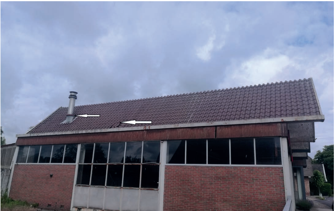
Foto 2: er bevinden zich enkele openingen in de dakpannen, maar deze bevinden zich op een plek met een slechte aanvliegmogelijkheid.
