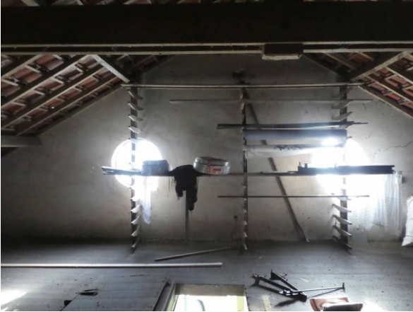
Figuur 15 Veel lichtinval en tocht door ontbreken dakbeschoot binnen in schuur
