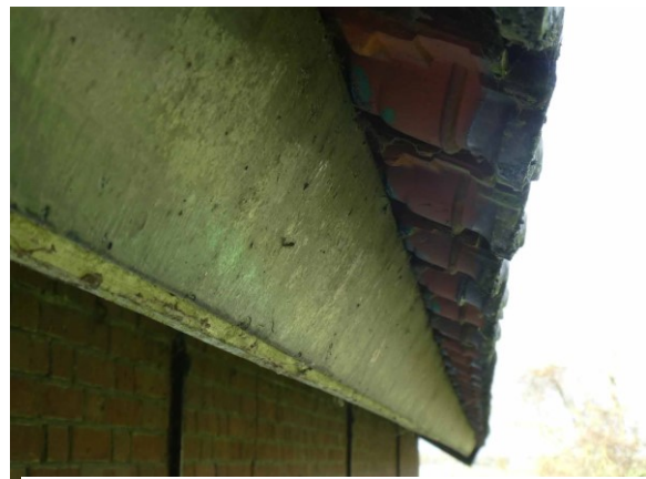
Figuur 9 Dakoverstek die schuin naar de muur van het gebouw wegloopt en dus geen aanhechting biedt voor huismussen
