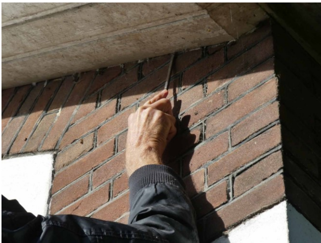
Figuur 13 Geen enkele ruimte aansluiting dakoverstek/gevel
