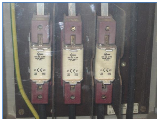
Asbest verdachte zekeringen (werkplaats)
