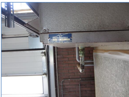
Asbest verdachte ventilatieunit (werkplaats)
