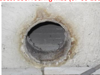
Asbest doorvoering M10 (07-06-2013)
