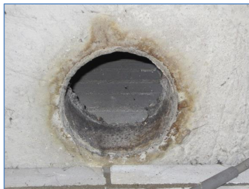
Asbest doorvoering in garage (Barwoutswaarder 87A)
