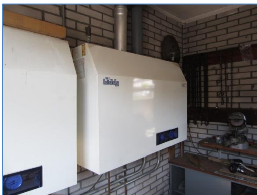
Asbest verdachte ketels cv-ruimte (werkplaats)
