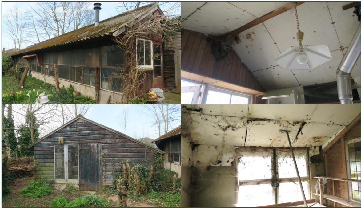
Figuur 3.1 De opslagruimte (4; links boven) en schuur (5; links onder) zijn van binnen voorzien van piepschuim platen waarin vochtplekken zichtbaar zijn (foto's rechts). Potentiële invliegopeningen zijn enkel aanwezig onder het uitstekende gedeelte van de daken.
