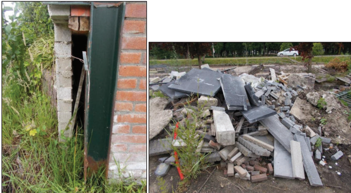
Foto 7 – 8: Aanwezige hoop puin en holte in de muur.
