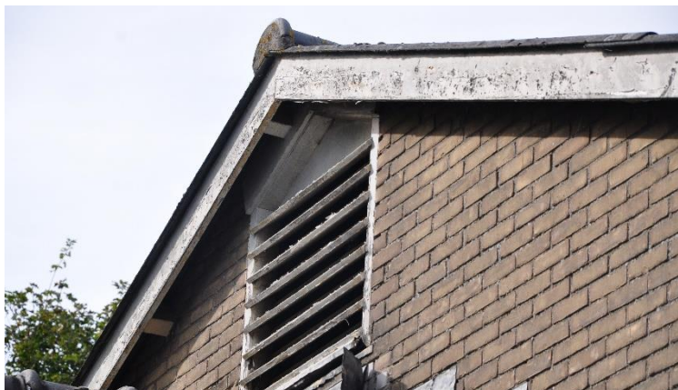
De opening naar de zolder waar steenmarter van gebruik kan maken (foto:Laneco).
