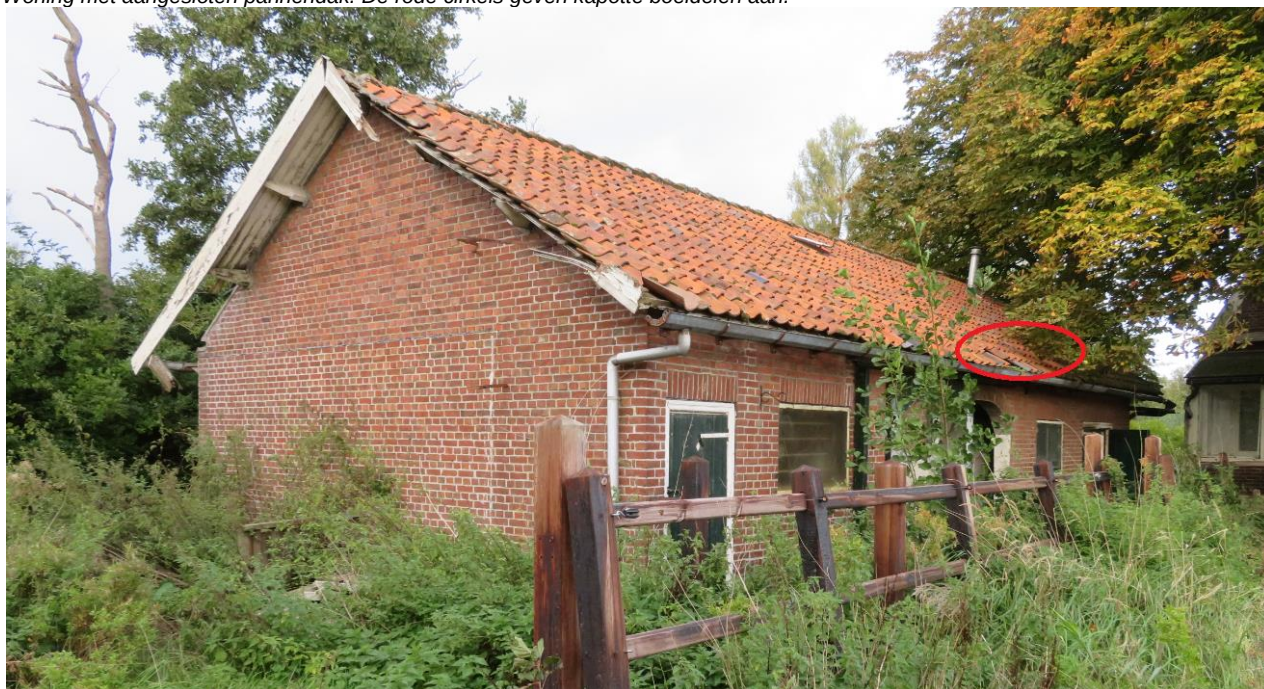
Bijgebouw. De rode cirkel geeft ontbrekende pannen aan.
