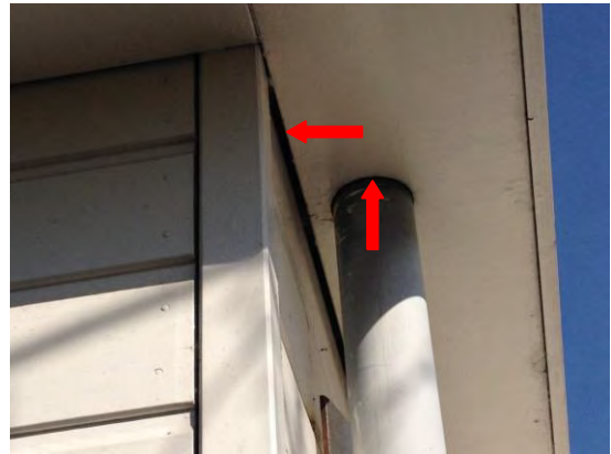
Foto 6: Ruimte rondom regenpijp en onder daklijst
