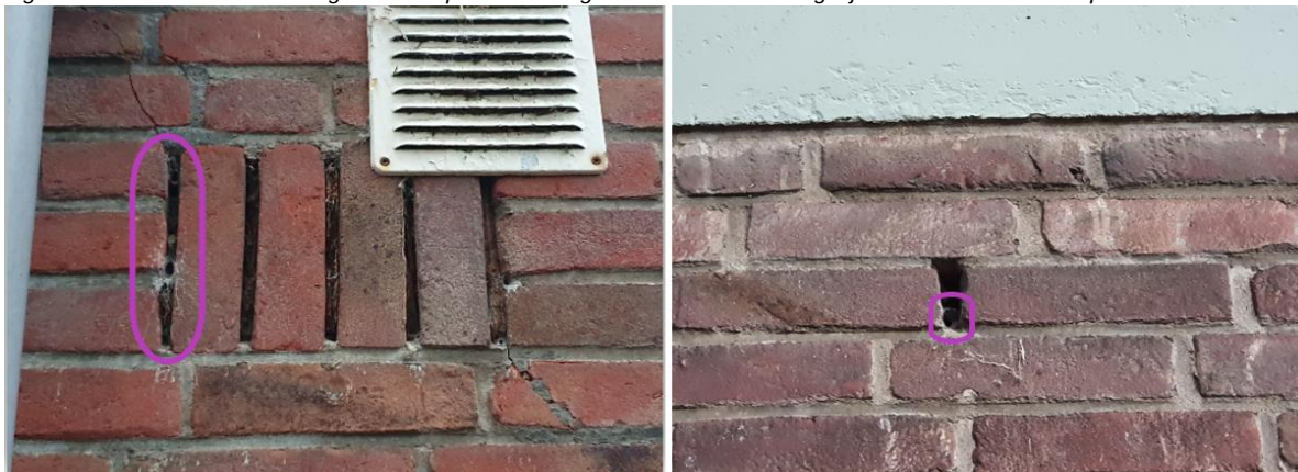
Fig. 7: voor vleermuizen ongeschikte open ventilatie- en stootvoegen met in de paarse kaders een type trechterspin. De overige ventilatievoegen zijn dichtgestopt met zachtboard
