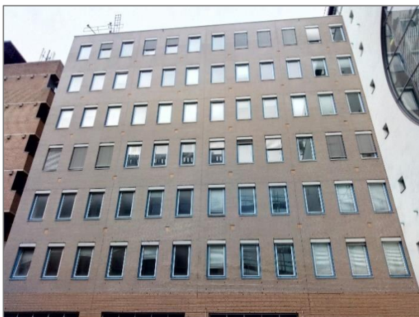
Afbeelding 4.5 | Gebouw D (bouwstijl van gebouw E en F hetzelfde): stootvoegen, dilatatievoegen en ruimte bij de dakrand, mogelijk ruimte onder kozijnen.
