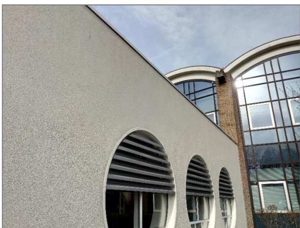
Afbeelding 4.11 | Smalle opening bij de dakrand van de uitbouw bij gebouw R.
