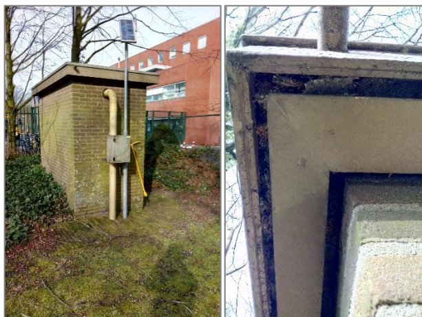
Afbeelding 4.12 | Elektriciteitshuisje ten westen van gebouw H met open dakranden.
