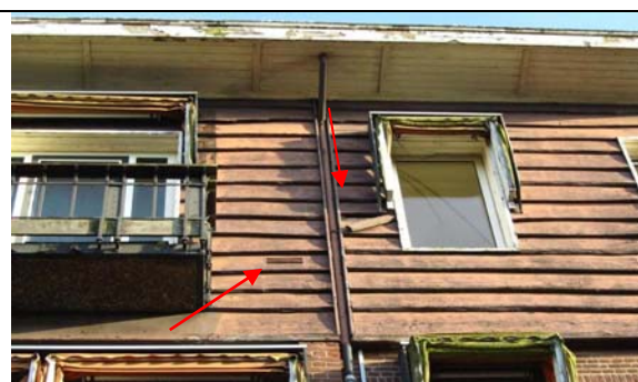
Foto 10: Ventilatierooster en loshangende planken waar vleermuizen weg kunnen kruipen.
