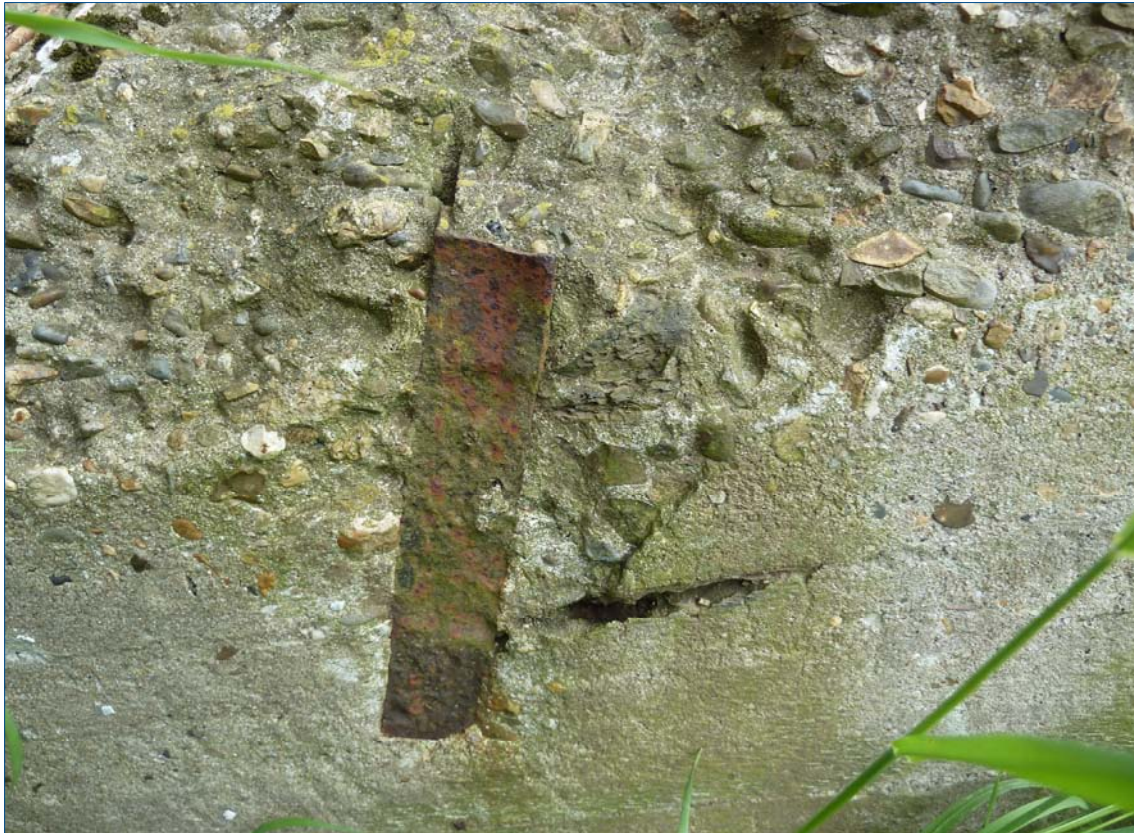
Figuur 6. In het pokdalige bovenvlak van het beton zijn hoekbalken van de wapening en sporen van een drillboor zichtbaar.
