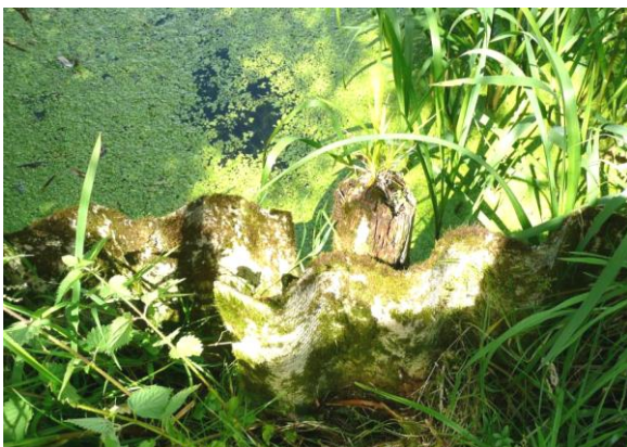
Foto's 8. Waarschijnlijk asbesthoudende materialen (14 juni 2016). Van boven naar onderen: golfplaten dakbedekking bedrijfsgebouw; ruitenkit; golfplaten beschoeiing langs sloot zuidzijde; en noordzijde.
