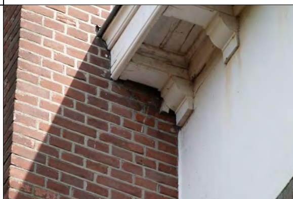
Opening tussen schoorsteen en dakbetimmering achterzijde
