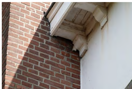
Foto 3. Opening tussen schoorsteen en dakbetimmering achterzijde postkantoor
