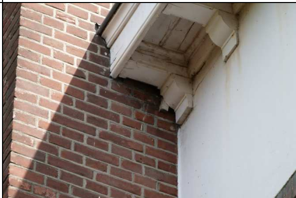
Opening tussen schoorsteen en dakbetimmering achterzijde
